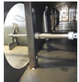
Vanne d'extraction des fumées
