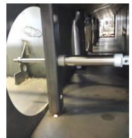
Válvulas extracción humos
